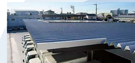
埼玉本部・全配送センターの屋上に太陽光発電パネルを設置
